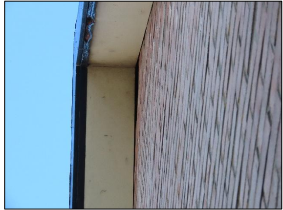
Fig. 1.15, Detailopname van dakoverstek, spleet tussen dakoverstek en muur zichtbaar (bron: FF Solutions)
