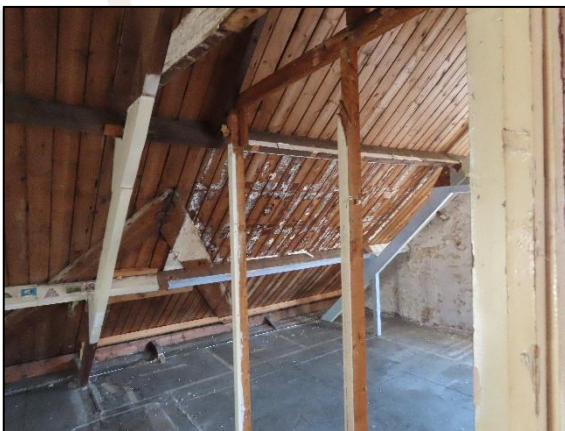
Fig. 1.4, Dakbeschoot in Nieuw Baarnstraat 33 (bron: FF Solutions)
