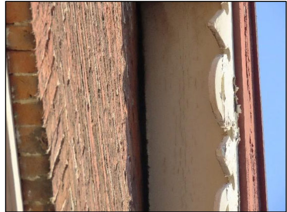
Fig. 1.9, Detailopname van dakoverstek, spleet tussen dakoverstek en muur zichtbaar (bron: FF Solutions)
