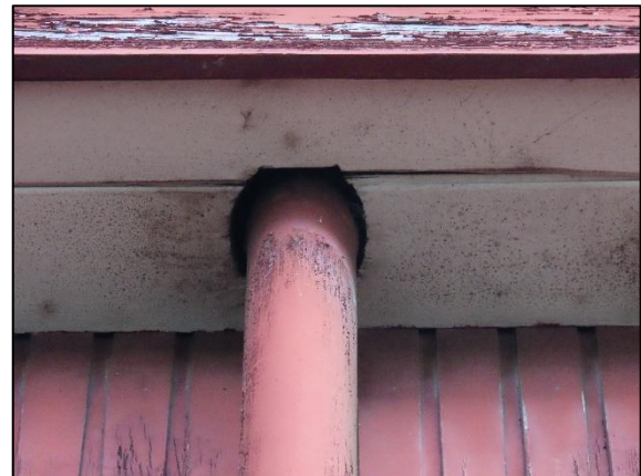
Fig. 1.11, Openingen bij regenpijpdoorvoer van Nieuw Baarnstraat 33 (bron: FF Solutions)
