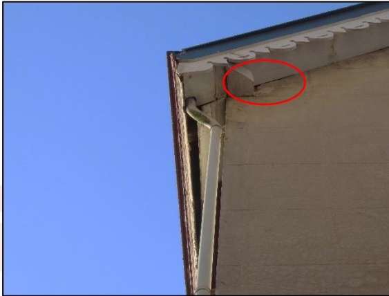
Fig. 1.8, Detailopname van dakgoot en dakoverstek. Ontbrekende plank bij dakgoot (midden) en spleet bij dakoverstek (rood omrand) (bron: FF Solutions)
