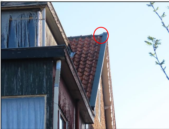
Fig. 1.10, Detailopname van dakvlak van Nieuw Baarnstraat 33. Ontbrekend cement in nok (rood omrand) (bron: FF Solutions)
