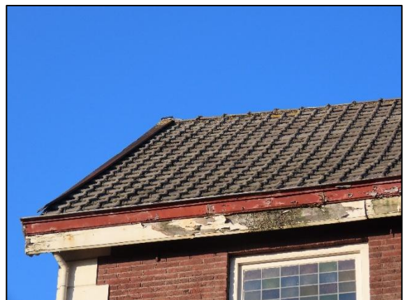
Fig. 1.7, Detailopname van dakvlak van Nieuw Baarnstraat 33. Waterbord kapot (links) (bron: FF Solutions)
